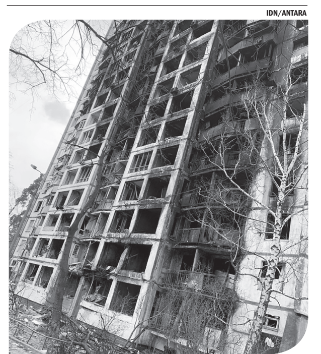
KERUSAKAN BANGUNAN DI WILAYAH KYIV - UKRAINA. Pemandangan kerusakan sebuah bangunan yang parah saat mundurnya tentara Rusia dari daerah tersebut selama invasinya, di Bucha, wilayah Kyiv, Ukraina, pada gambar yang diambil dari media sosial, Sabtu (2/4).
